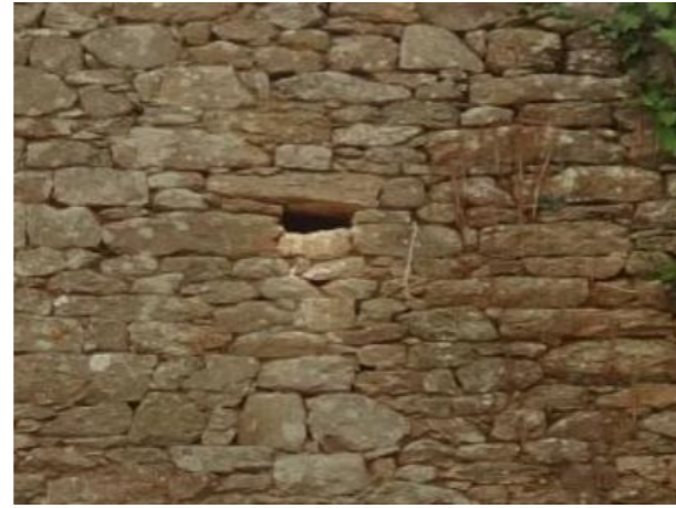
Photo 2 : Cavité de martinets noirs sur la façade est
