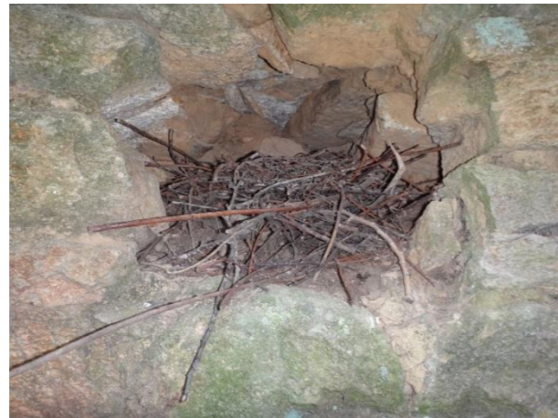
Photo 5 : Nid de merle noir dans le mur nord
