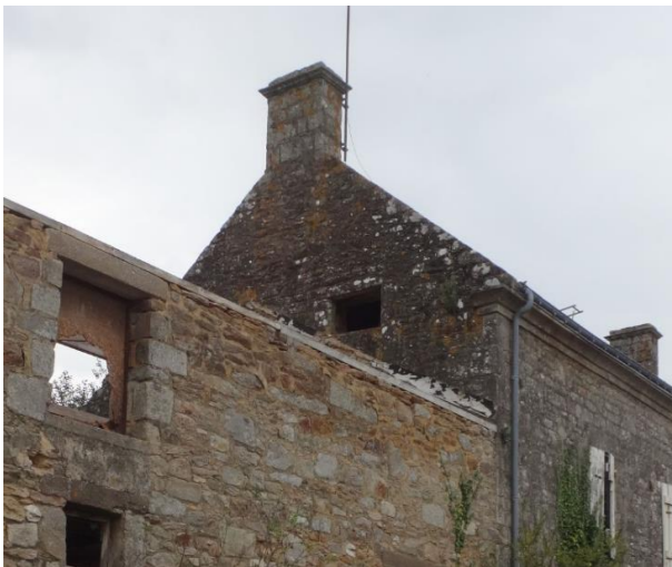
Photo 3 : Cavité de faucon crécerelle sur le pignon ouest
